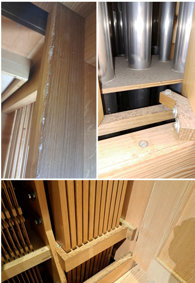
Bela plesen na nosilni konstrukciji sapnice glavnega piščalja (zgoraj levo), plesen na žaluzijski mehaniki (zgoraj desno) in v igralniku (spodaj). (Aleš Razpotnik)
